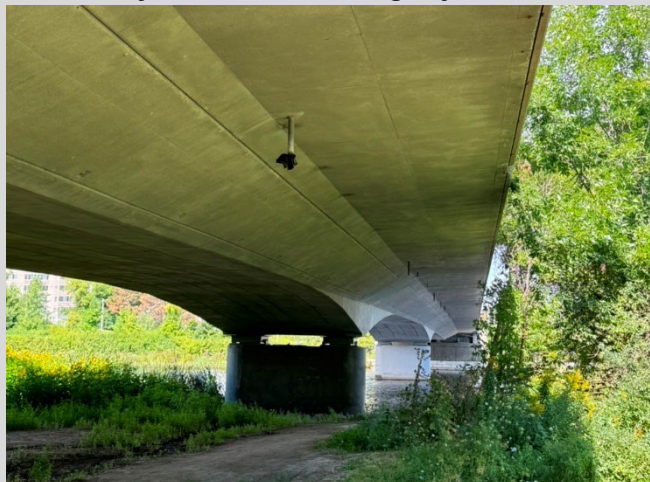
Structure 013010 – Passerelle enjambant la rivière Rideau (Pont du Transitway de l'avenue Carling enjambant la rivière Rideau)
