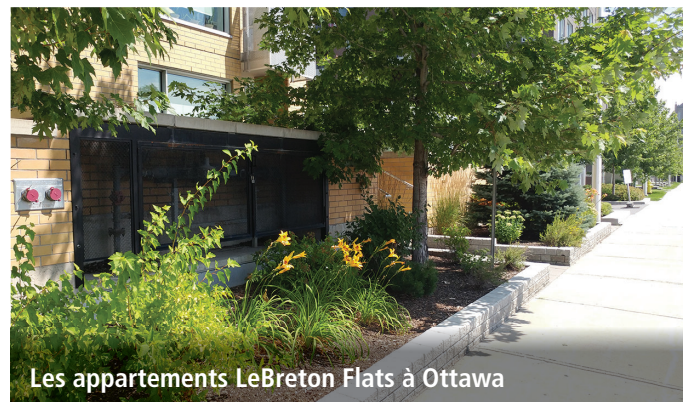
Figure 55 : Intégration des compteurs de gaz et d'autres raccords de services publics dans l'esthétique de l'architecture et du paysage
