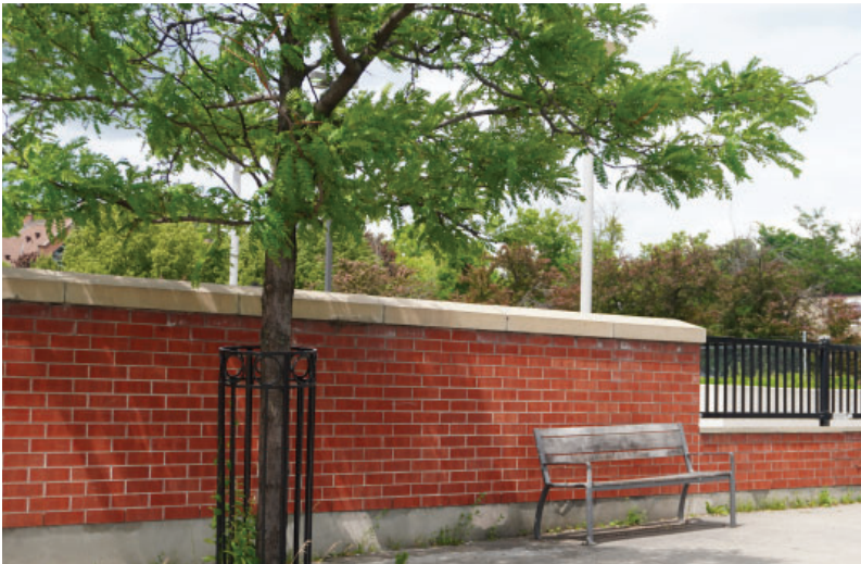
Figure 25 : Ce mur de brique plein établit la lisière de la rue et masque le stationnement depuis la rue.
