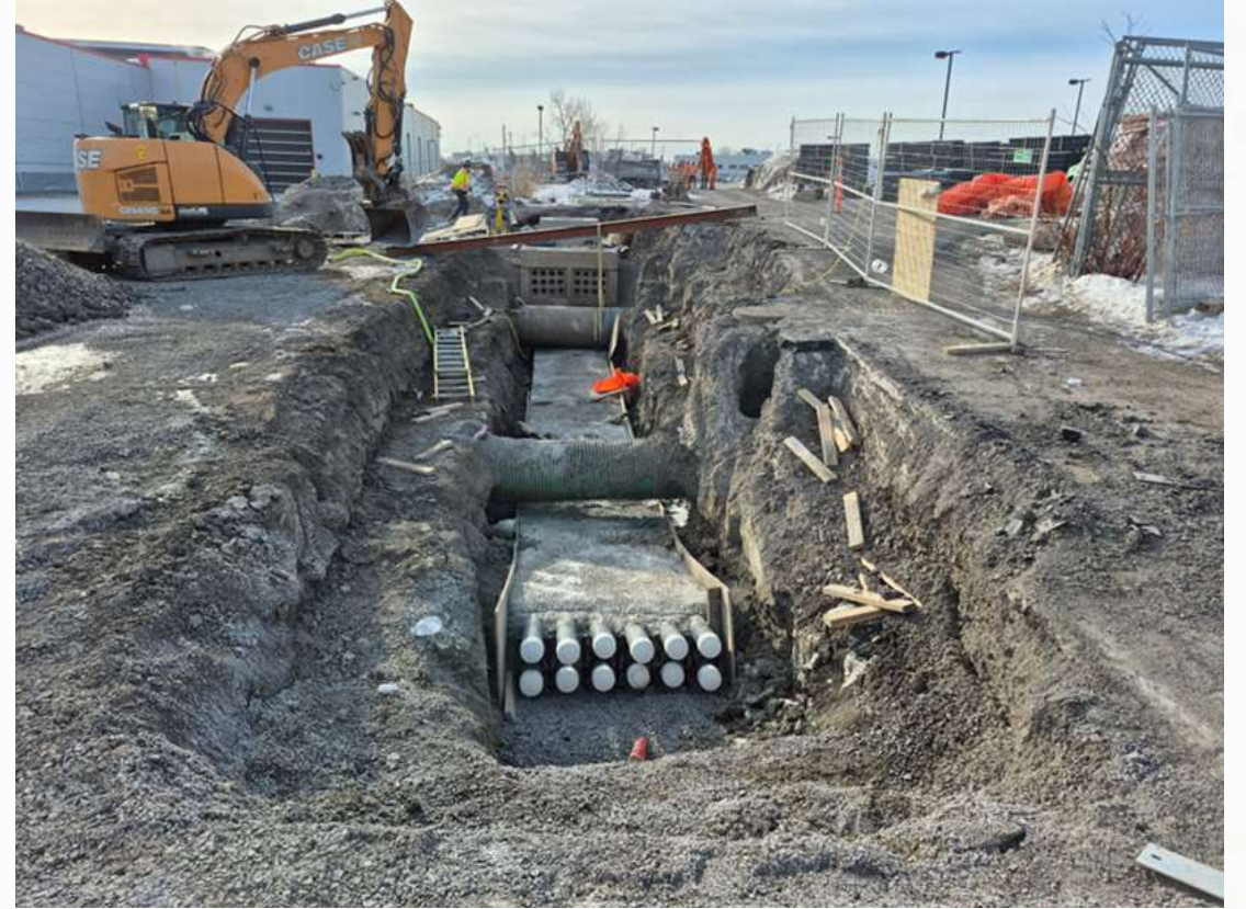
Distribution de l'énergie électrique
